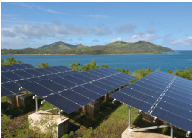
Solar PV modules Fiji.
